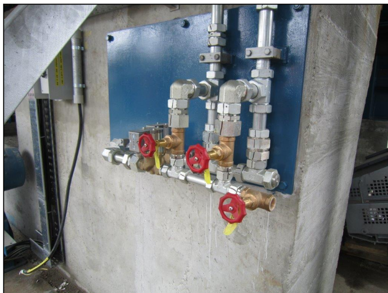
Photo de l'alimentation du réseau de RIA et de la rampe d'extinction (ligne de broyage similaire)
