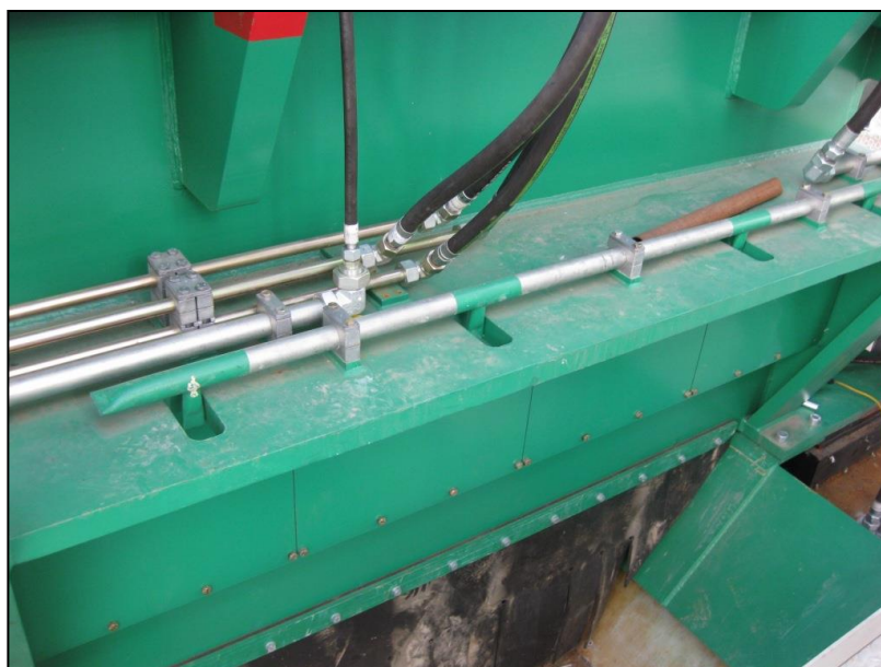
Rampes d'aspersion extinction de la chambre de broyage (ligne de broyage similaire)
